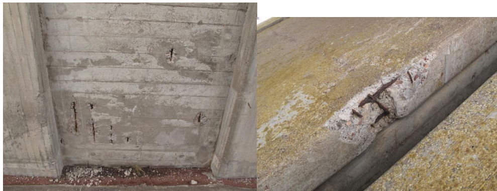
Figur 5 Exempel av skador vid skivpelare th och båge tv.
