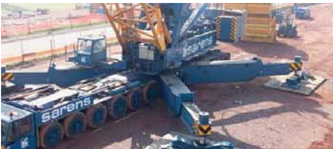
Mycket tung kran på en arbetsplattform som är stabiliserad med Tensar geonät
