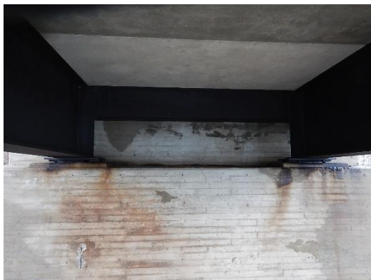
Figur 21.1 Typskada på frontmur
