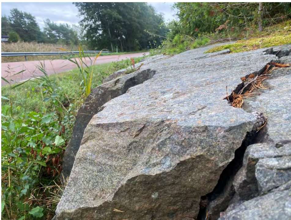
Figur 9. Påbörjad stjälpning av block nära km 0/000 i slänt mot nordost. Resultande skärning längre bort är "ful" på grund av att man ställt skärningen mot geologin i stället för att utnyttja naturligt förekommande slag i berget.
