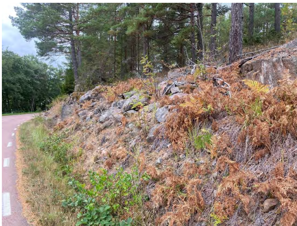
Figur 29. Slänt på befintlig vägs norra sida, Material har fallit ut. Ca 1/225. Ny väg planeras ca 20 m norr om befintlig för att förbättra sikt i kurvan.
