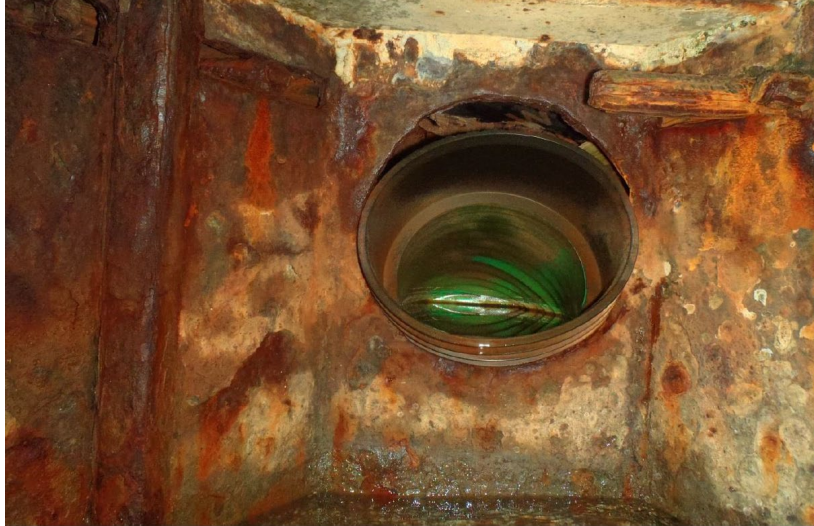
Bild 8: Dagvattenrör med otät genomföring i spont och negativ lutning på rör.
