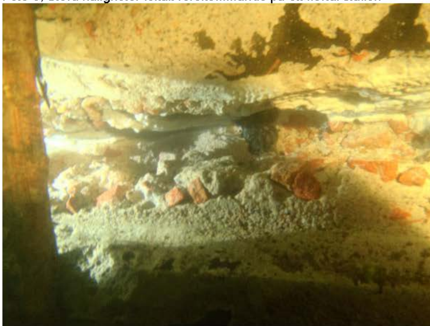
Foto 4, Omfattande förekomst svaga skikt i inhomogen betong.
