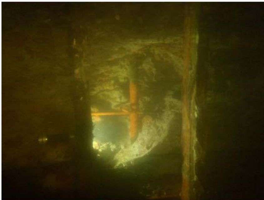
Foto 3, Stora håligheter lokalt förekommande på ett flertal ställen
