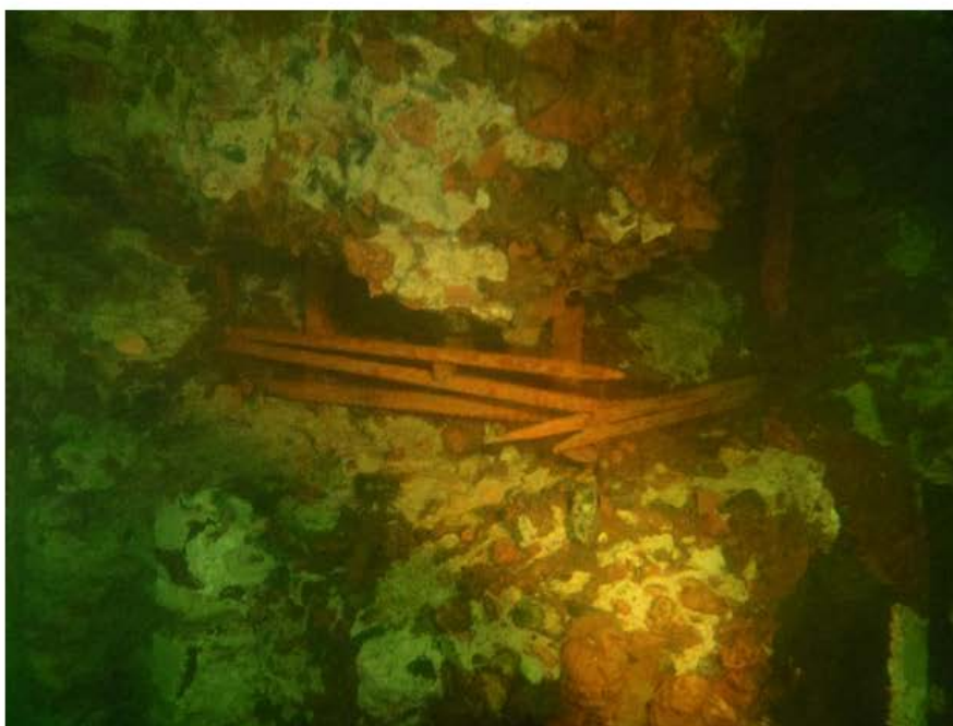
Foto 2, Djupgående skador på betong och armering
