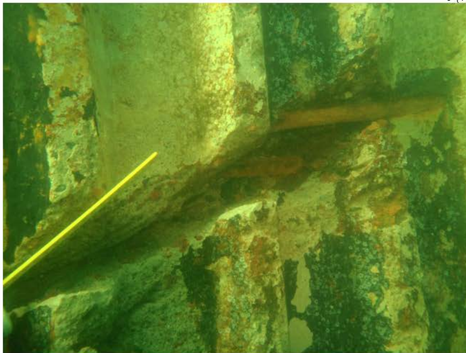
Foto 5, Omfattande förekomst svaga skikt i inhomogen betong.
