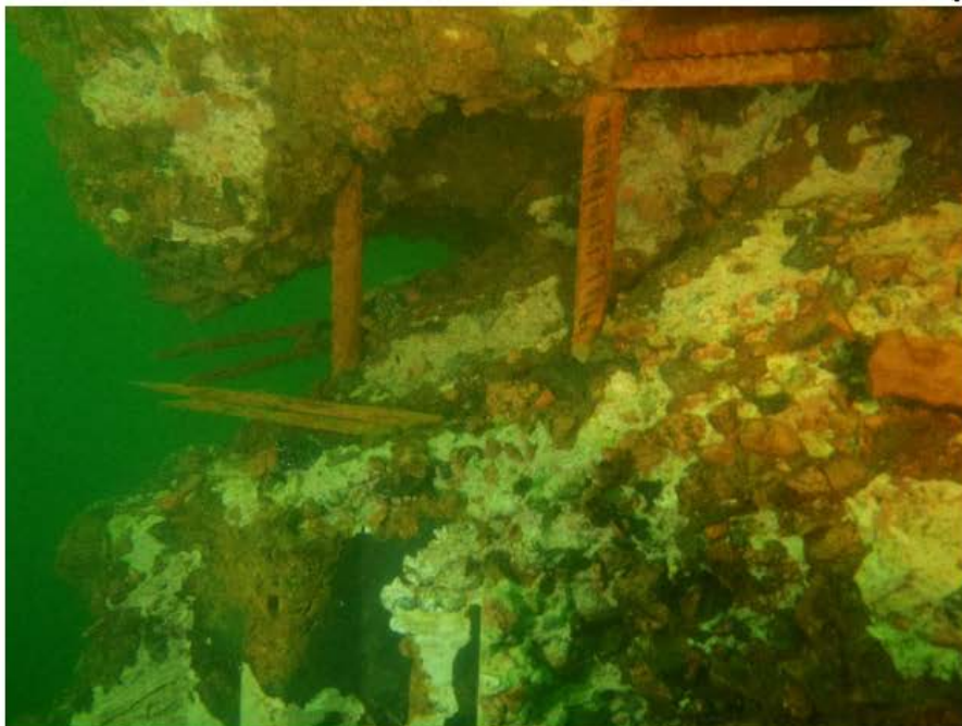
Foto 1, Mycket djupgående skador i svaga betongskikt samt omfattande armeringskorrosion
