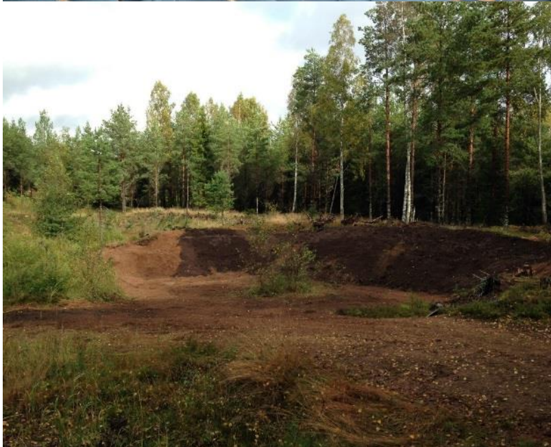
Figur 11. En skyddsåtgärd för att stabilisera schaktkanten och minska på framtida skada och erosion genomfördes på Svinvallen år 2015. Bilden till vänster visar cellduken som lades ut och fylldes med jord, och bilden till höger slutresultatet. I bilden Andreas Mickelsson, landskapets fastighetsverk. Foto Jenni Lucenius.
