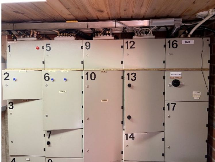
Bild 2 Befintligt apparatskåp och centraler
