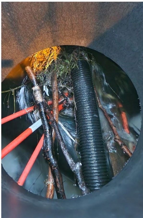
Igensatt dagvattenbrunn i Mariehamn. Källa: Mariehamns stad.
