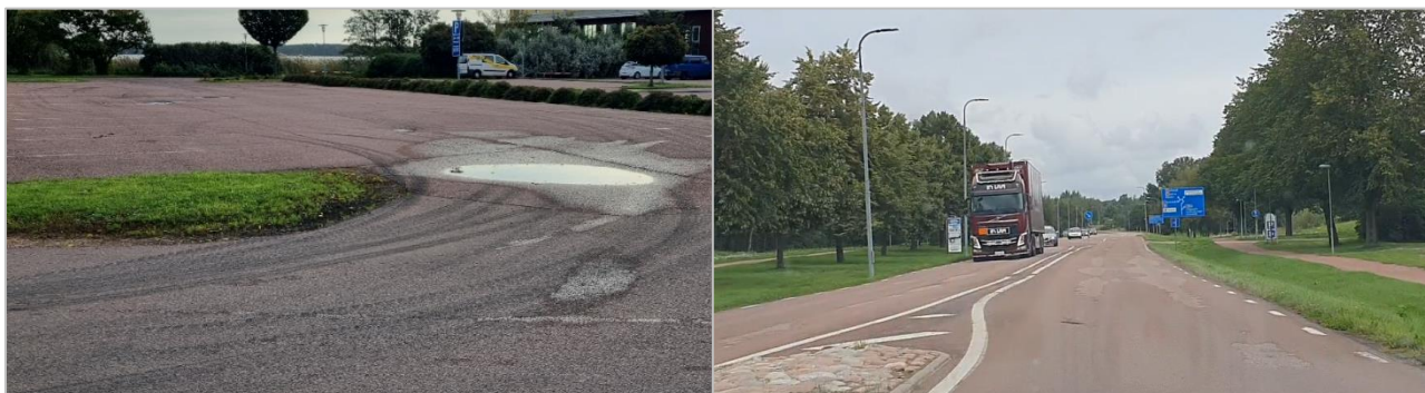
Figur 12. Till vänster: Ojämnheter i parkering utanför badhuset. Foto: AFRY, 2023-09-25. Till höger: Sättningskador i vägen innan beläggningsarbete hösten 2023, taget mot norr vid övergångsställe utanför badhuset. Foto: Ålands landskapsregering
