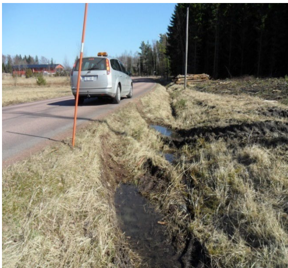
Skador på diken och vägtrummor där den som orsakat skadorna är återställnings-/ersättningskyldig.
