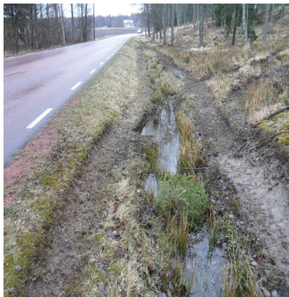
Skador på diken och vägtrummor där den som orsakat skadorna är återställnings-/ersättningskyldig.
